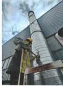
压铸、天然气燃烧废气 排气筒出口
